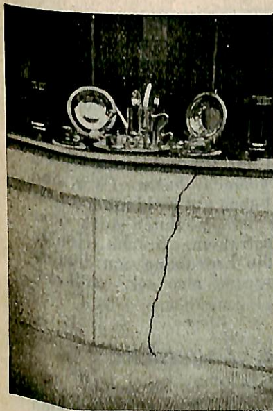
3 Riss durch den Granitsockel eines Ladens, verursacht durch Unterstrahlung.
