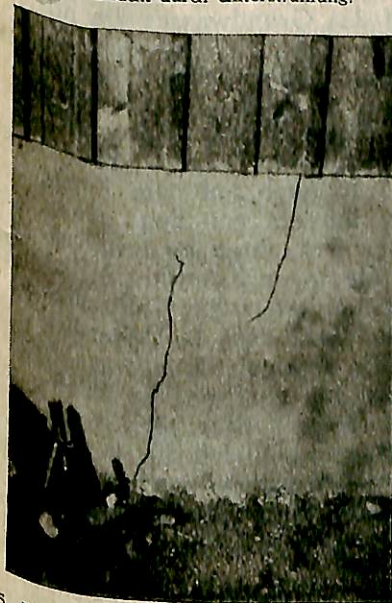
5 Risse über unterstrahlten Stellen eines auf Fels fundamentierten Gebäudes.
